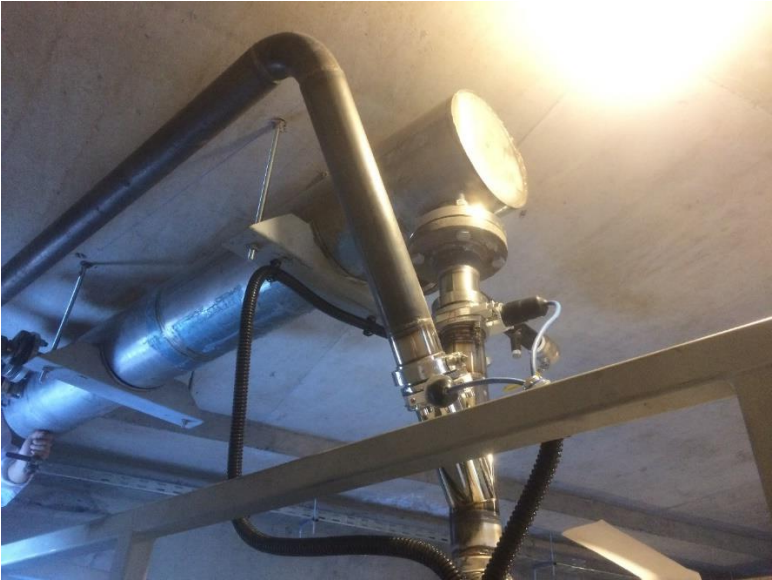
Figura 10.24 Sistema de escape. Fuente: Elaboración propia.
