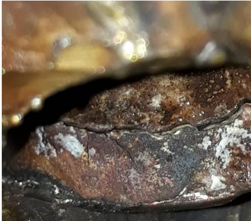
Figura 10.58: Grieta interior tubo. Fuente: Elaboración propia.
