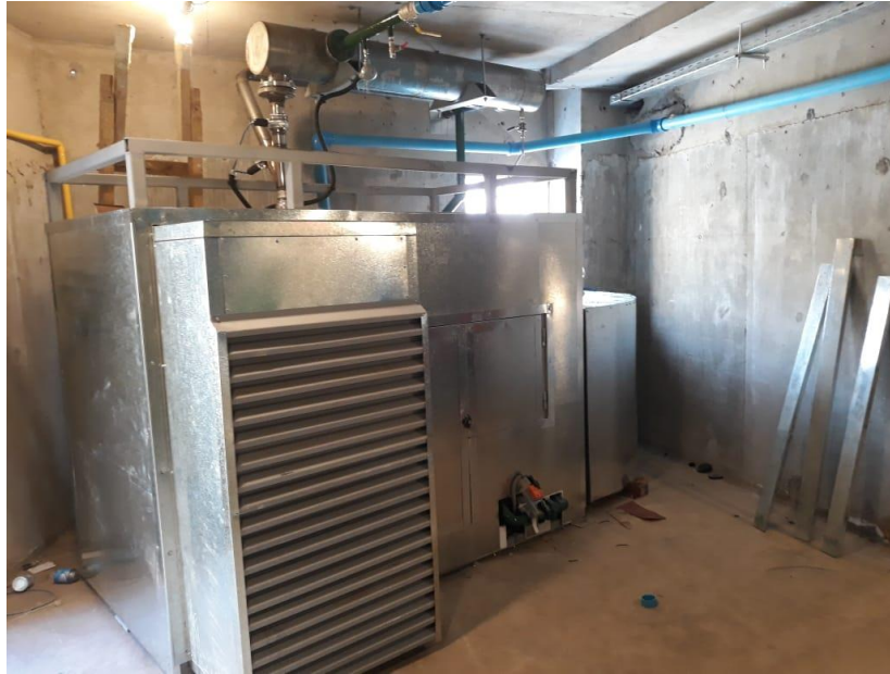
Figura 10.25 Módulo de cogeneración. Fuente: Elaboración propia.
