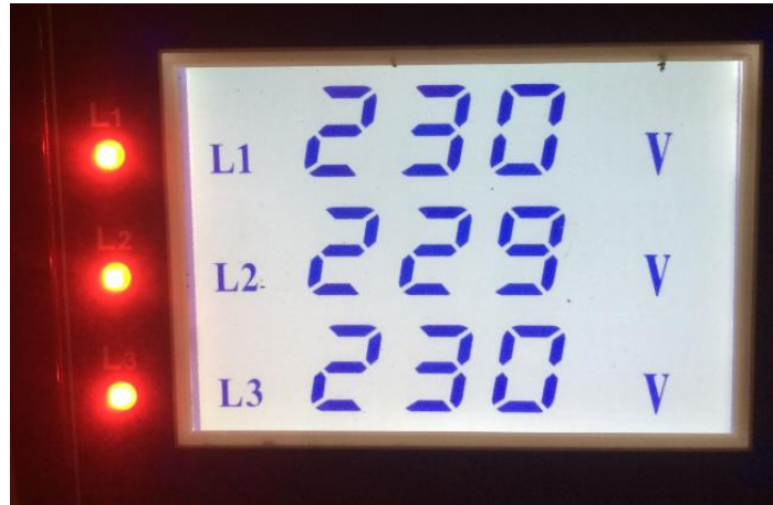
Figura 10.26 Medidor de parámetros - Voltaje por fase. Fuente: Elaboración propia.
