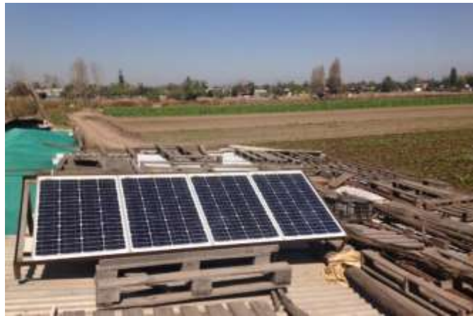
Figura 10. Panel solar en vivienda de un arrendatario del Campus Antumapu.
