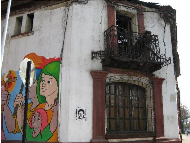
Estado de deterioro en algunos inmuebles.
