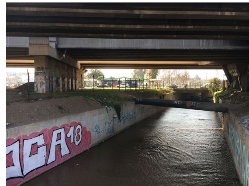
IMG 40. Zanjón de La Aguada. Av. Américo Vespucio. Fotografía propia. 07-09-2018.
