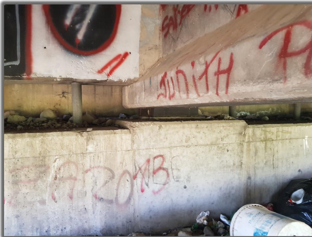
Figura 2-2: Elastómeros y barras antisísmicas del puente Águila Norte (vista estribo)
