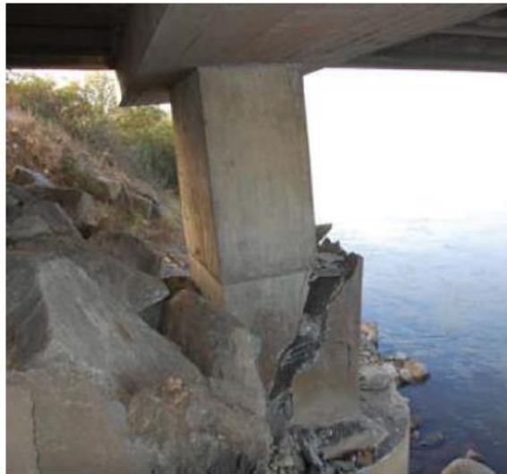
Figura 2-5. Falla por capacidad al corte en columna en puente Juan Pablo II producidas por empuje lateral (lateral spreading). Fuente: Kawashima (2011)
