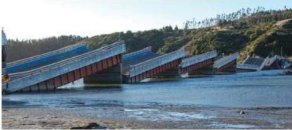
Figura 2-6. Colapso debido a licuefacción en el Puente Tubul. Fuente: Kawashima (2011)
