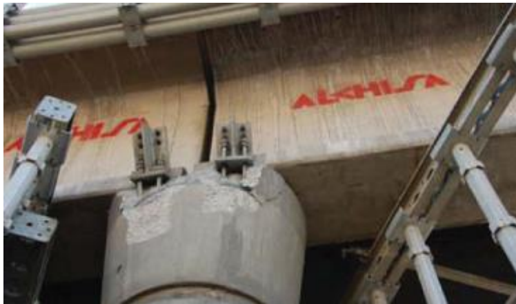
Figura 2-4. Falla debida a la una resistencia inadecuada de topes sísmicos laterales (metálicos), Paso Superior Lo Echevers. Fuente: Kawashima (2011)
