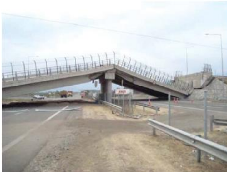
Figura 2-2. Colapso del Puente Romero debido a falla en las vigas de hormigón pretensado. Fuente: Kawashima (2011)
