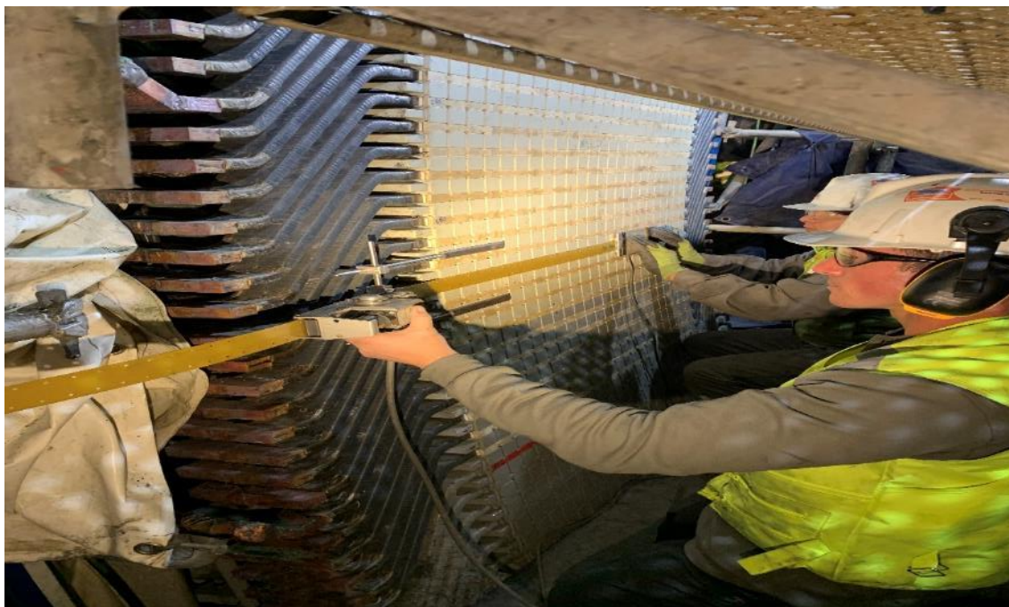
Figura A.25 Reparaciones de Bobinado de Cuartos Inferiores
