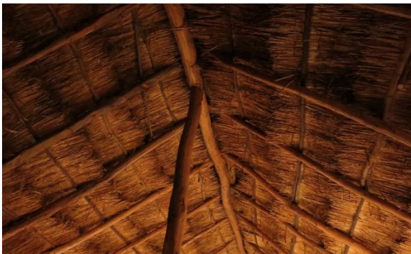
Figura 3.3 Detalle del techo de una de las construcciones en desuso de Venera (Guzmanes).
