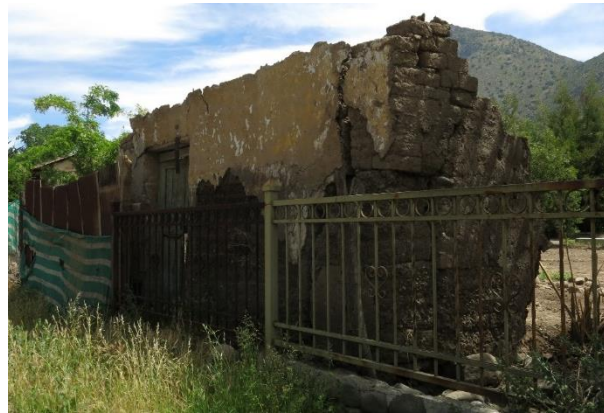
Figura 2.7 Vestigios del frontis de una casa antigua, delante de una nueva (Guzmanes).
