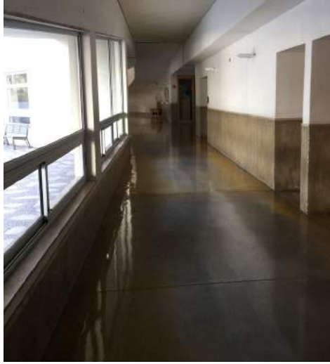
Figura 30: Piso de Universidad Adolfo Ibañez en Santiago terminación lisa Fuente: Elaboración propia
