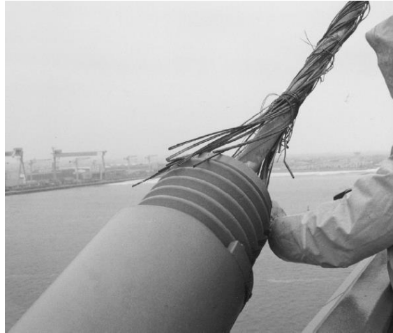
Fig. 1.6 Ejemplo de falla de cable en extremos, D. Siegert y P. Brevet (2005).
