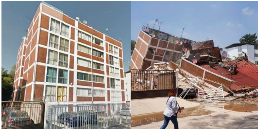
Figura 2.5: Colapso edificio de albañilería de 6 pisos. (Subrayado MX, 2018a)
