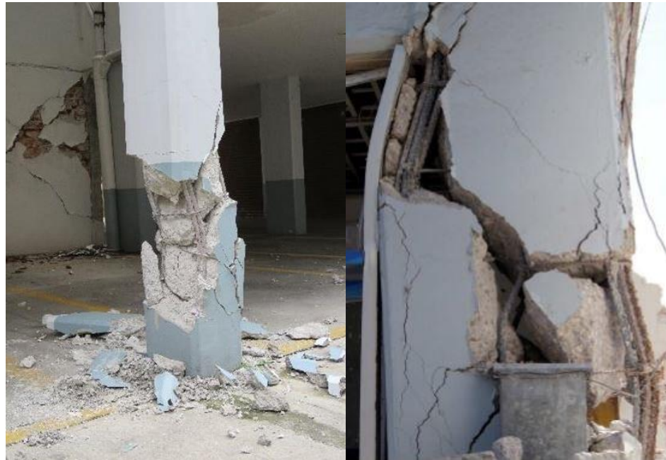
Figura 2.4: Caso de falta de confinamiento. (Astroza, 2017; Galvis et al., 2017)
