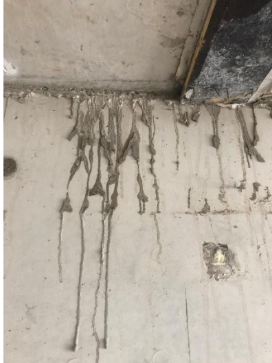
Ilustración 4.2. Ejemplo de muro con escurrimiento de lechada ya endurecida, Obra C.
