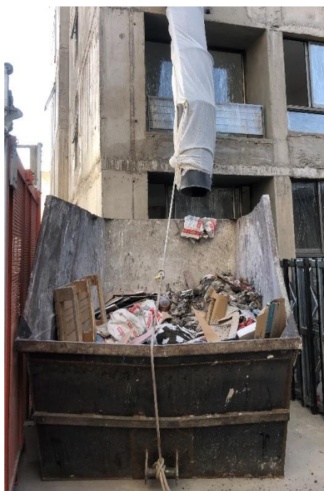
Ilustración 3.9. Ducto desescombrador, Obra C.
