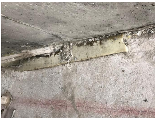
Ilustración 4.3. Material absorbente remanente en encuentro de muro y losa, Obra A.
