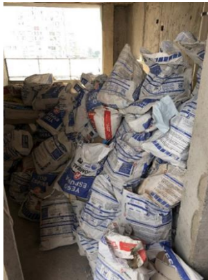
Ilustración 5.7. Sacos de rafia reutilizados para acopio de escombros en altura, Obra A.
