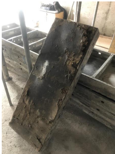
Ilustración 4.4. Placa fenólica descartada por mal estado, Obra A.
