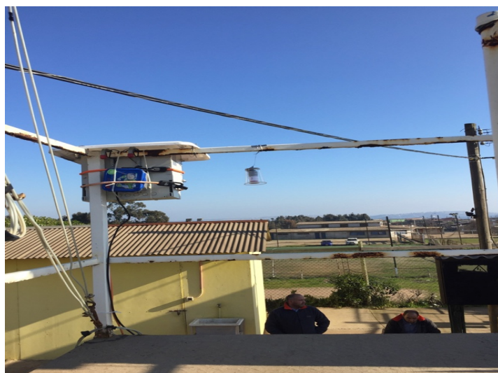
Figura 14 Fotografías de Plataforma LoV-IoT 2B ubicada en Estación Ventanas, junto con tubo pasivo de NO 2 .
