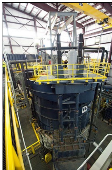
Ilustración 2: Celda de flotación FLSmidth, Aprimin, 2015.
