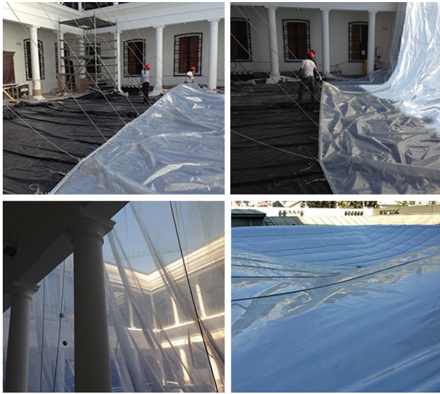
Fotografías de construcción de cubierta patio norte Museo precolombino, archivo de Smiljan Radic.
