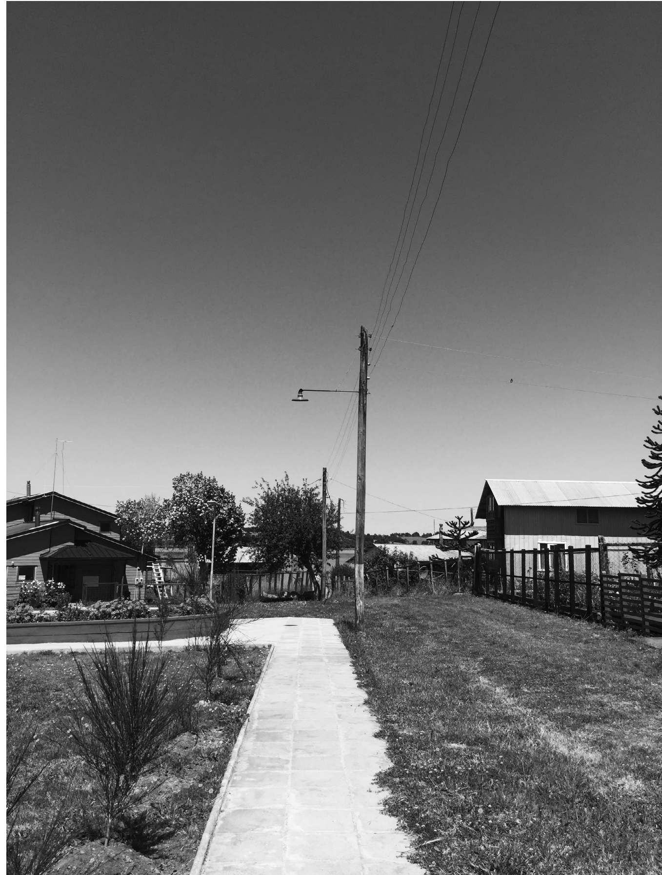
Poste eléctrico con alumbrado público Plaza principal de Mechuque Autor: Elaboración Propia
