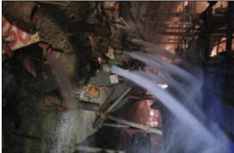
Ilustración 2.31. Infiltración de agua a alta presión durante el desarrollo del proyecto Jinping II, (C. Zhang, N. Liu, W. Chu, 2016).
