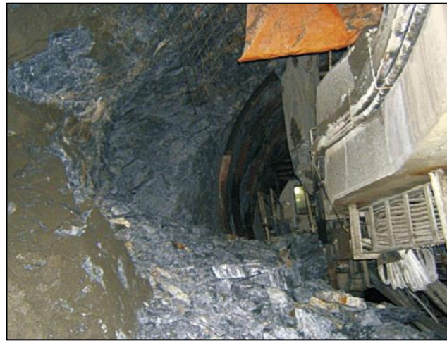
Ilustración 2.25. Estallido de roca en el proyecto Jinping II, (Zheng, 2016).
