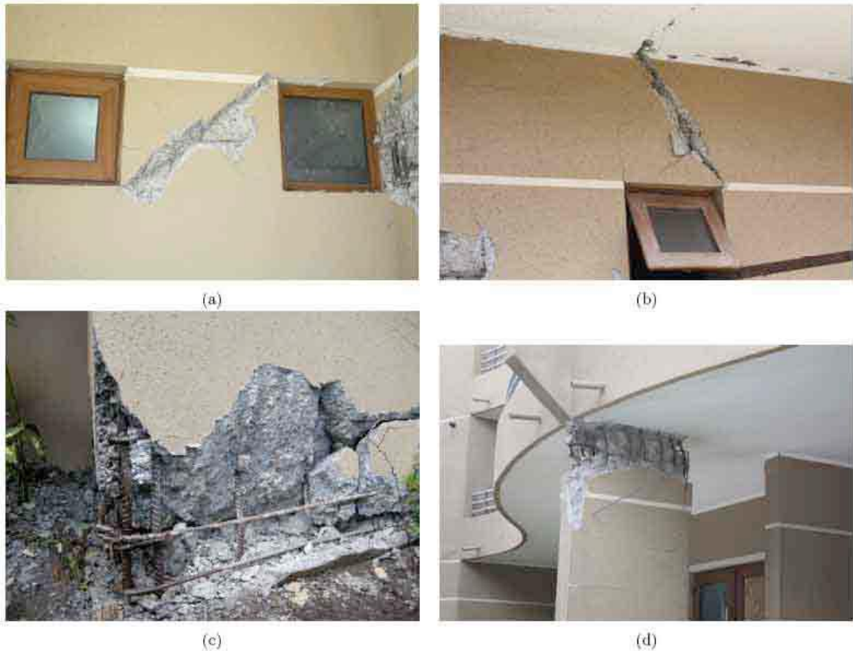
Figura 109: Daños generales apreciados desde el exterior [21]
