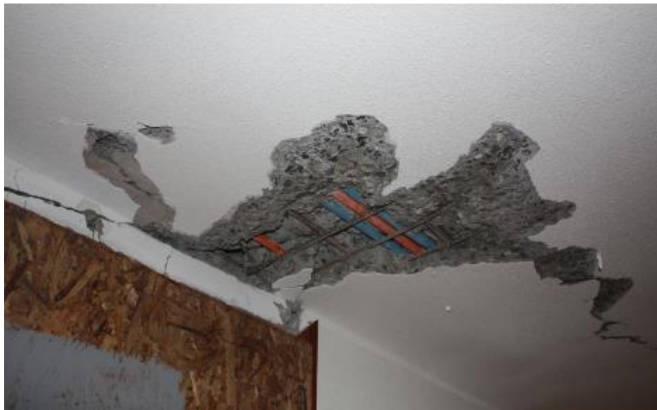
Figura 120: Daño en losas debido a puertas o aberturas
