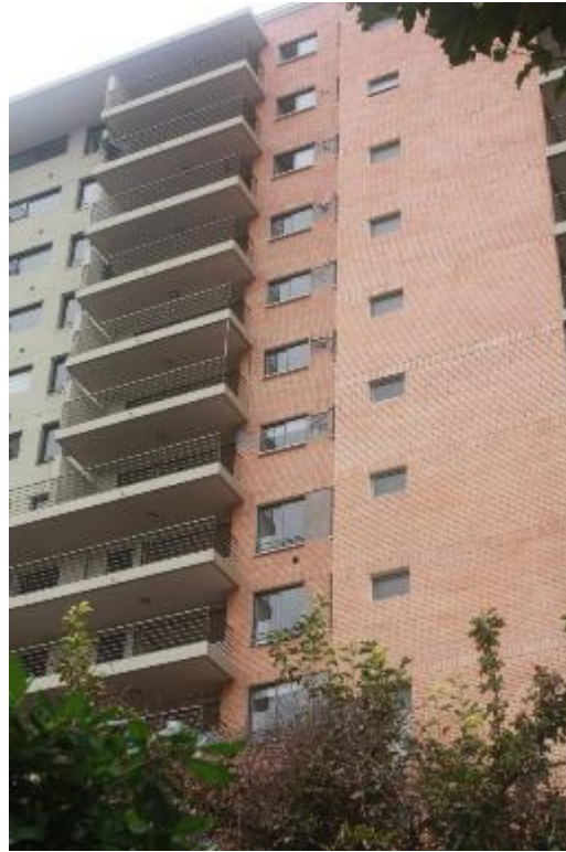
Figura 69: Daños en el eje E vistos desde el exterior (1) Fuente: Fotos inspección en terreno
