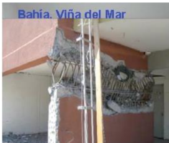
Figura 38: Daño nivel V en muro producido flexo-compresión [11]
