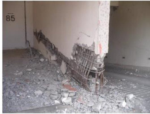
Figura 12: Falla en muro T [10]
