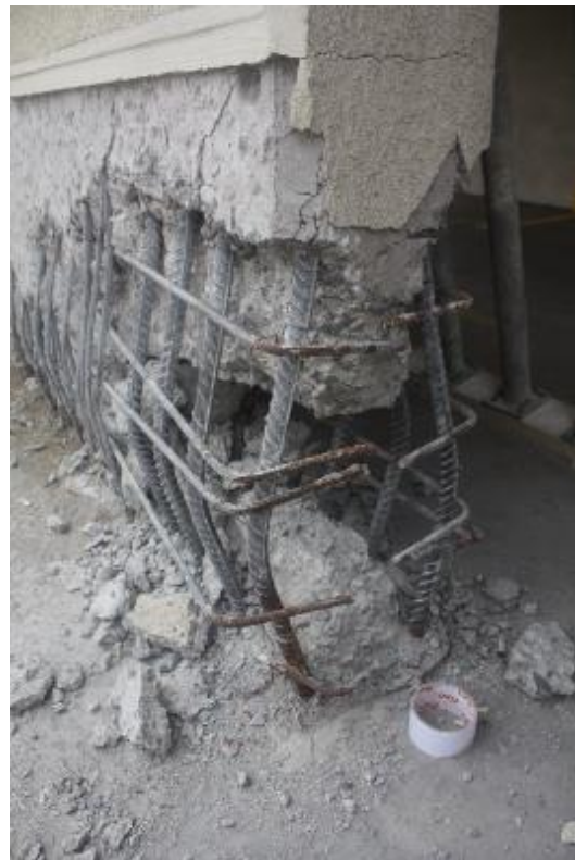
Figura 75: Vista cercana muro dañado eje 16 Fuente: Fotos inspección en terreno
