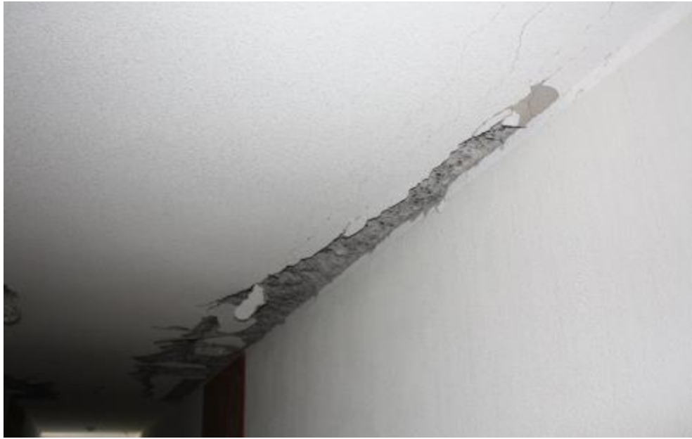
Figura 121: Daño en losas de forma paralela al pasillo
