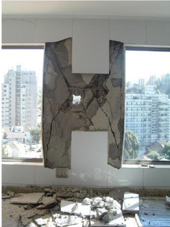
Figura 87: Daño eje E fachada norte, falla por corte [18]
