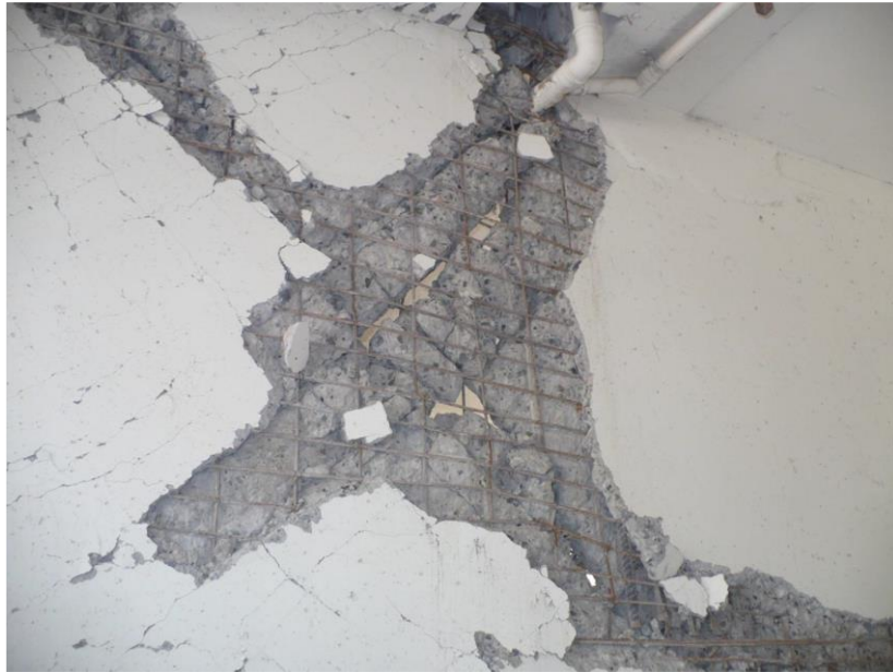
Figura 41: Daño nivel IV por corte en muro Fuente: CI5504 Patología de las obras de Construcción, 2018 FCFM
