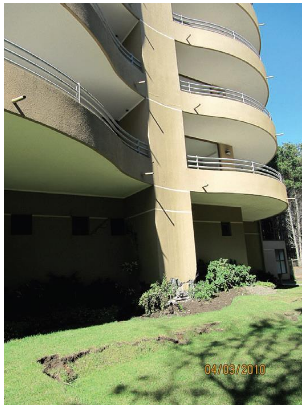
Figura 108: Asentamiento del suelo [22]
