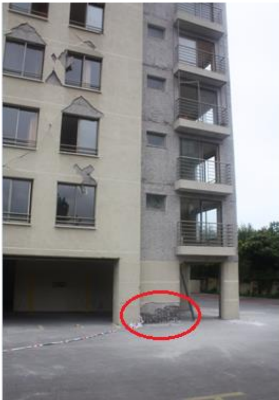
Figura 74: Vista lejana muro dañado eje 16 Fuente: Fotos inspección en terreno
