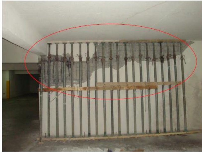
Figura 81: Vista general muro dañado eje 14, primer subterráneo [17]
