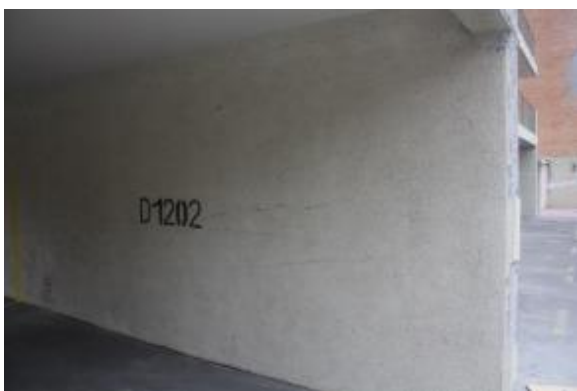
Figura 77: Fisuras en estacionamiento primer piso (1) fuente: Fotos inspección en terreno
