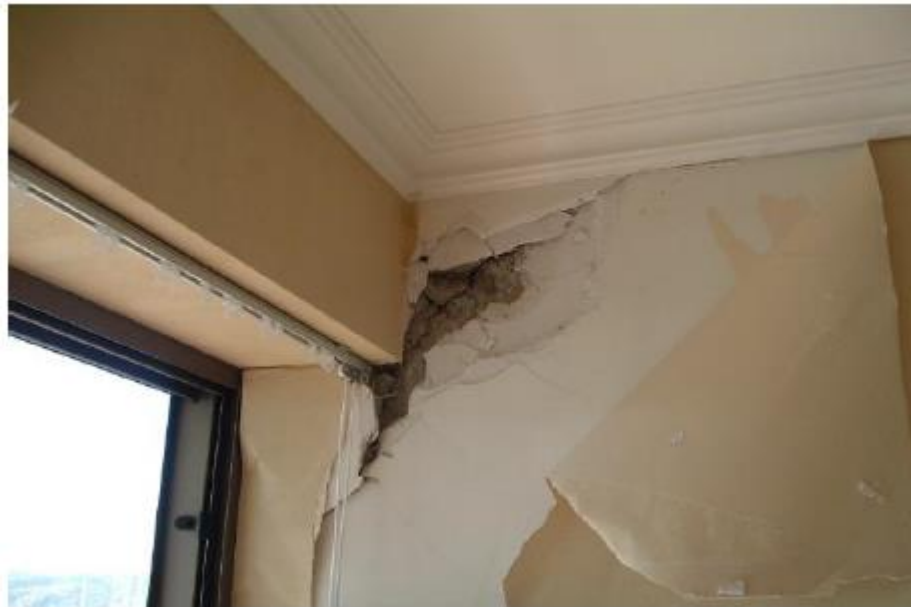
Figura 89: Daño eje K (1) [18]
