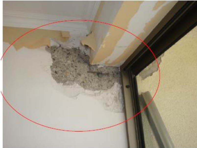
Figura 90: Daño eje K (2) [17]
