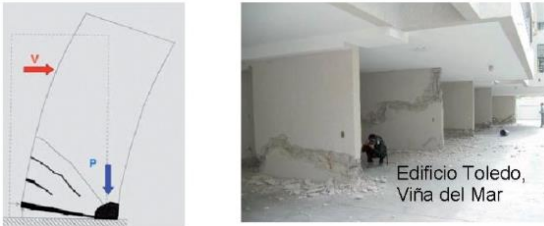
Figura 10: Fallas en muro debido a flexo-compresión [11]
