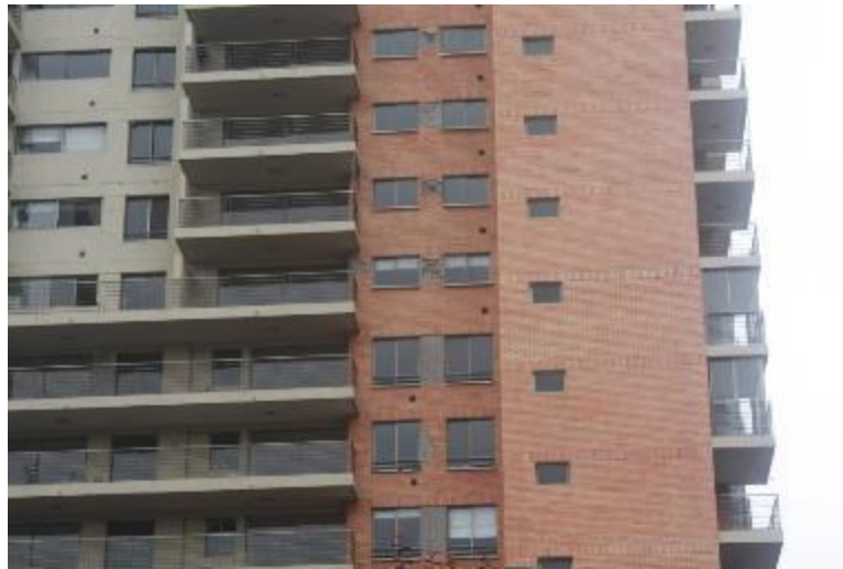
Figura 70: Daños en el eje E vistos desde el exterior (2) Fuente: Fotos inspección en terreno
