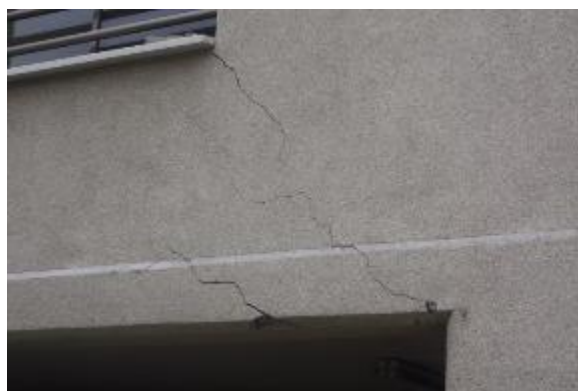
Figura 78: Fisuras estacionamiento primer piso (2) Fuente: Fotos inspección en terreno
