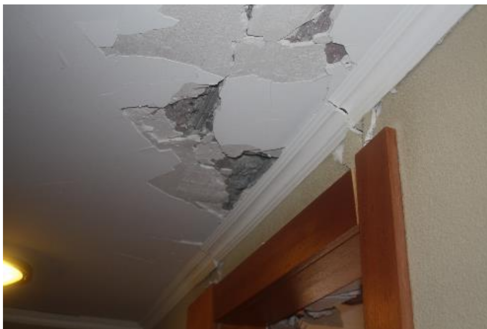
Figura 92: Daño en losas eje H Fuente: Fotos inspección en terreno
