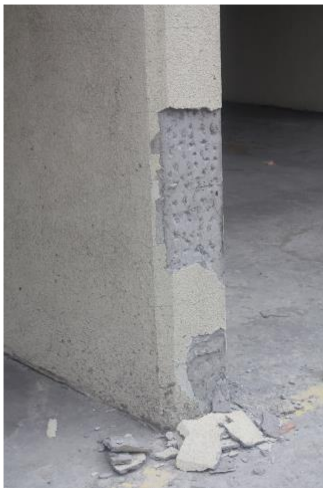
Figura 79: Desprendimiento de hormigón en muros estacionamiento primer piso. Fuente: Fotos inspección en terreno
