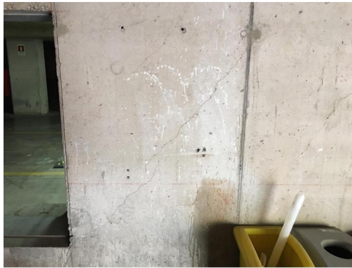
Figura 39: Daño nivel II en muro por corte Fuente: Foto tomada en terreno, Edificio Av. Del Valle 534, Huechuraba
