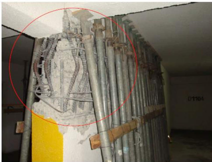
Figura 82: Zona más dañada muro eje 14, primer subterráneo [17]
