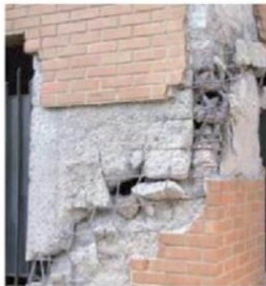
Figura 42: Daño nivel V por corte en columna [11]
