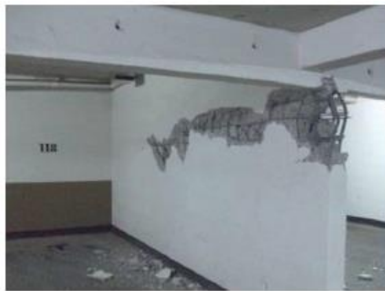
Figura 11: Efecto de muros transversales. Edificio Sol oriente, Santiago [11]
