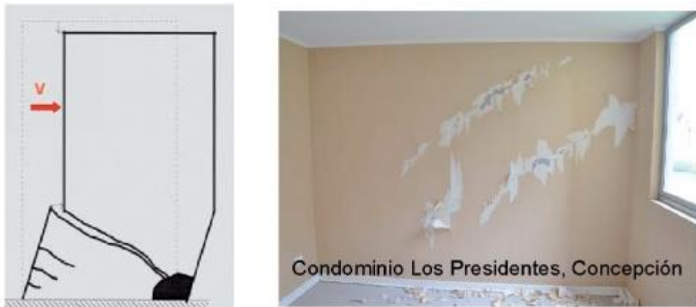
Figura 9: Fallas en muros debido al corte [11]
