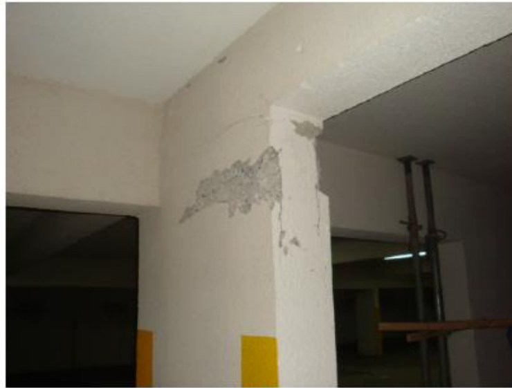
Figura 86: Daño muro eje 16/B primer subterráneo. [17]
