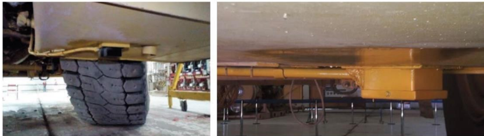
Ilustración 13. A la izquierda se observa el primer sensor instalado sin protección, y a la derecha el segundo sensor con la estructura metálica incorporada
