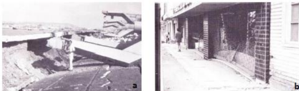
Figura 3.21: a) Desplazamiento del molo de bloques de concreto en Sitio 1 del Puerto de San Antonio y b) Asentamientos diferenciales en edificio de San Antonio (Yadlin et al., 2012)
