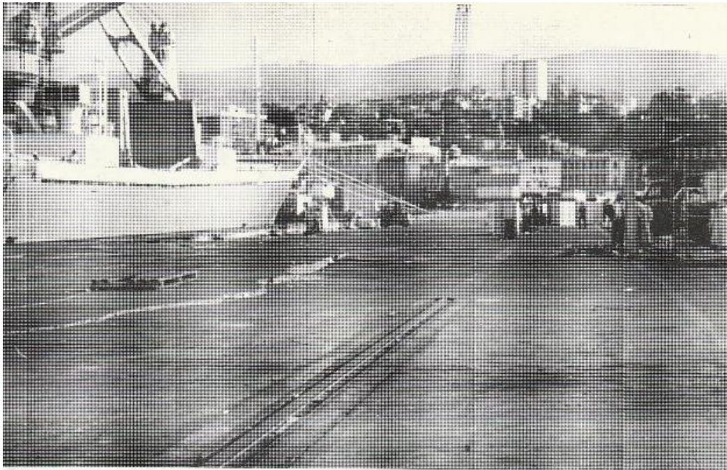
Figura 3.37: Daños en la unión de los sitios 4 y 5 (Monge et al, 1986)
