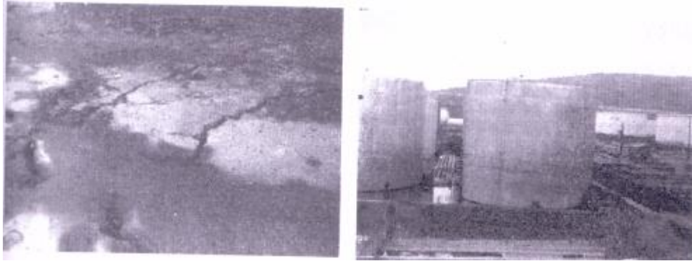
Figura 3.6: A la izquierda se presentan cráteres con eyección de barro en las cercanías de la refinería ENAP, a la derecha se tiene el asentamiento diferencial de estanques fundados sobre arena (Monge et al, 1965)
