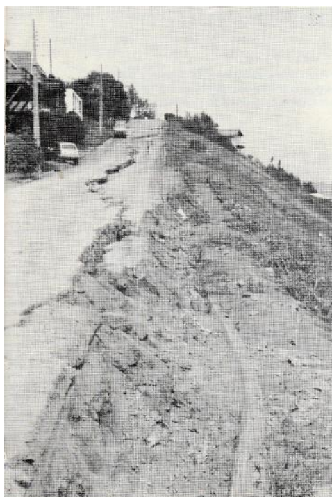
Figura 3.33: Deslizamiento en camino a Reñaca Alto. (Monge et al, 1986)
