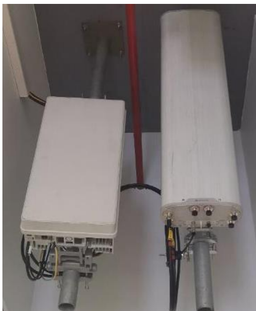
Figura 41: Antena 5G y RAN 4G montados en las instalaciones de WOM
