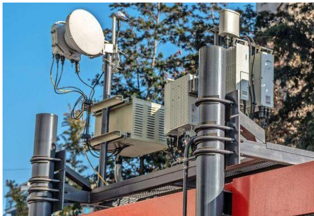
Figura 36: Paradero de bus con antenas 5G
