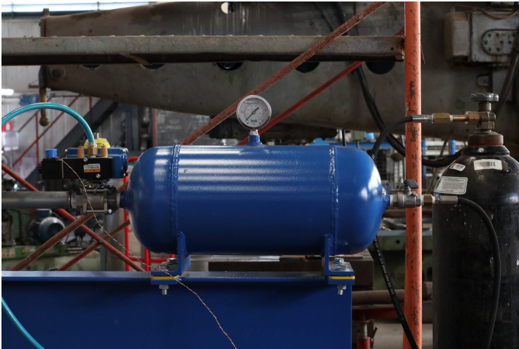
Figura 5.4: Estanque de gas.
