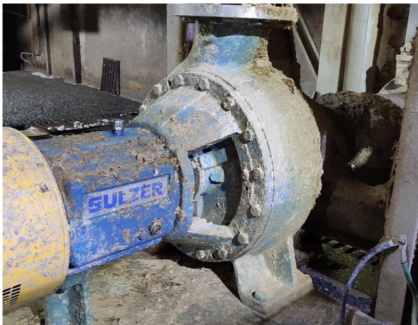
Figura 4.7: Bomba Estanque ATS-300
