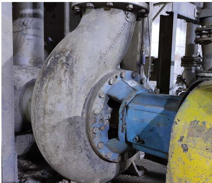
Figura 4.25: Bomba Alimentación 1era Etapa Cleaners
