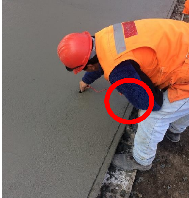
Figura 11: Colocación y Posición terminales Sensor Instrumentación C01
