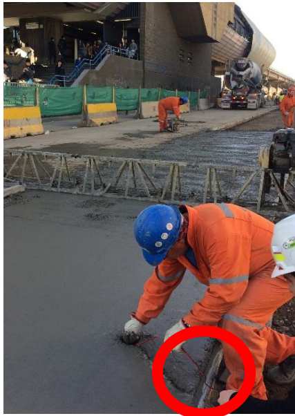
Figura 12: Colocación y Posición terminales Sensor Instrumentación C02
