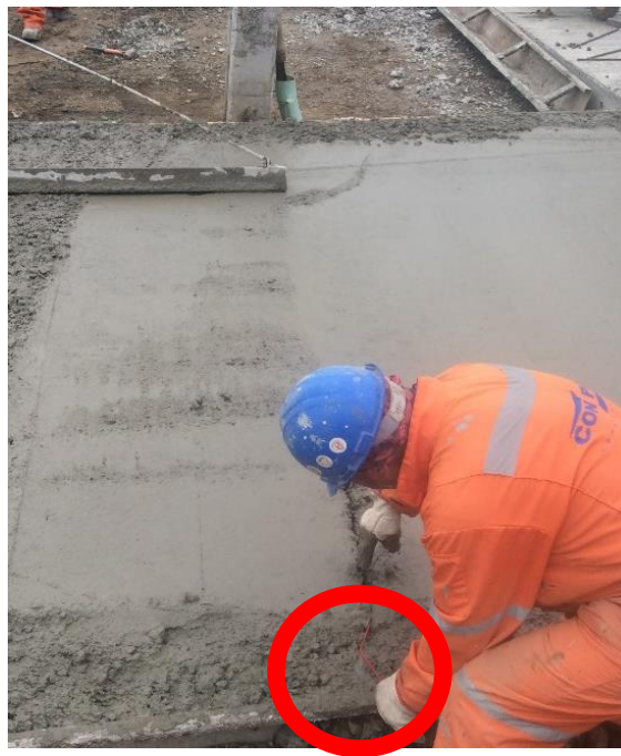
Figura 16: Colocación y Posición terminales Sensor Instrumentación C06
