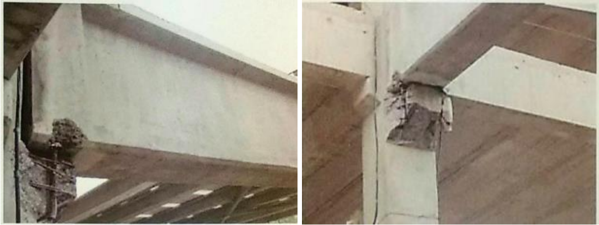
Figura 2.21: Daños en consolas de apoyo. Fuente: Campusano & Cortés (2012)
