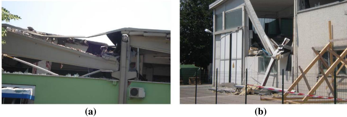
Figura 2.24: Ejemplos de colapsos debido a la pérdida de soporte de los elementos horizontales. Fuente: (Magliulo et al. 2014).
