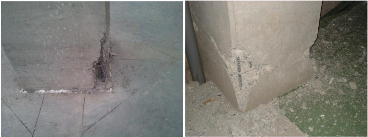
Figura 2.22: Daños observado en la base pilares prefabricados. Fuente: Mancini (2016)
