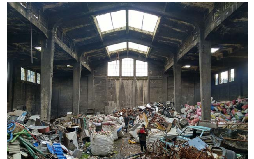
Imágenes Derecha Conjunto de imágenes referentes al estado actual del edificio de reparaciones Fuente: Concurso de Arquitectura Red Tenzando / Fichaje de lesiones - Anexo 3.1
