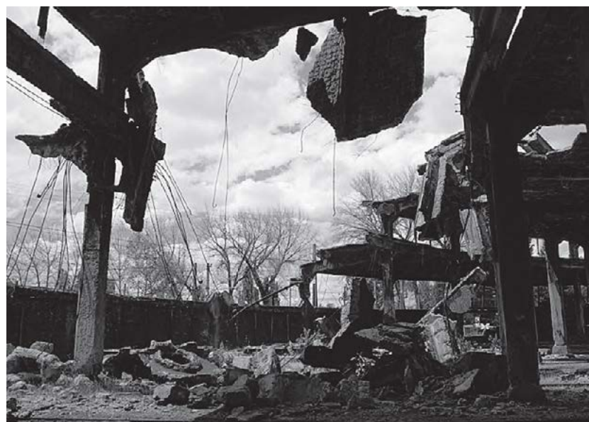
Imagen Superior Estado de conservación de la maestranza de Chillán Fuente: Montero y Muñoz, 2012
