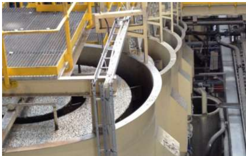
Figura 16: equipos de flotación SFR en operación
