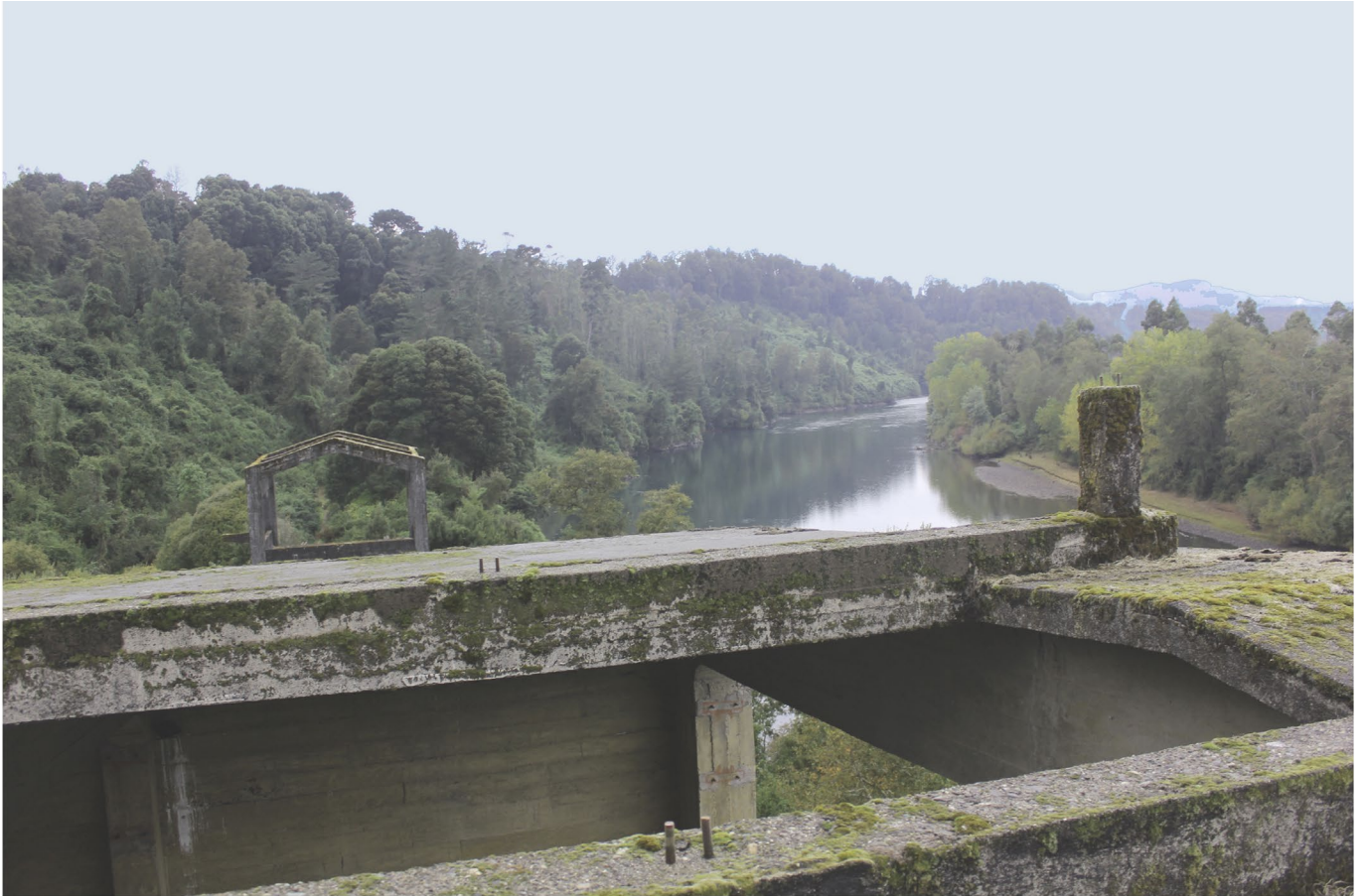
IMG.19_ Vista desde el la cubierta del Edificio Principal. Fuente: Archivo de Expedientes, CMN Los Ríos.
