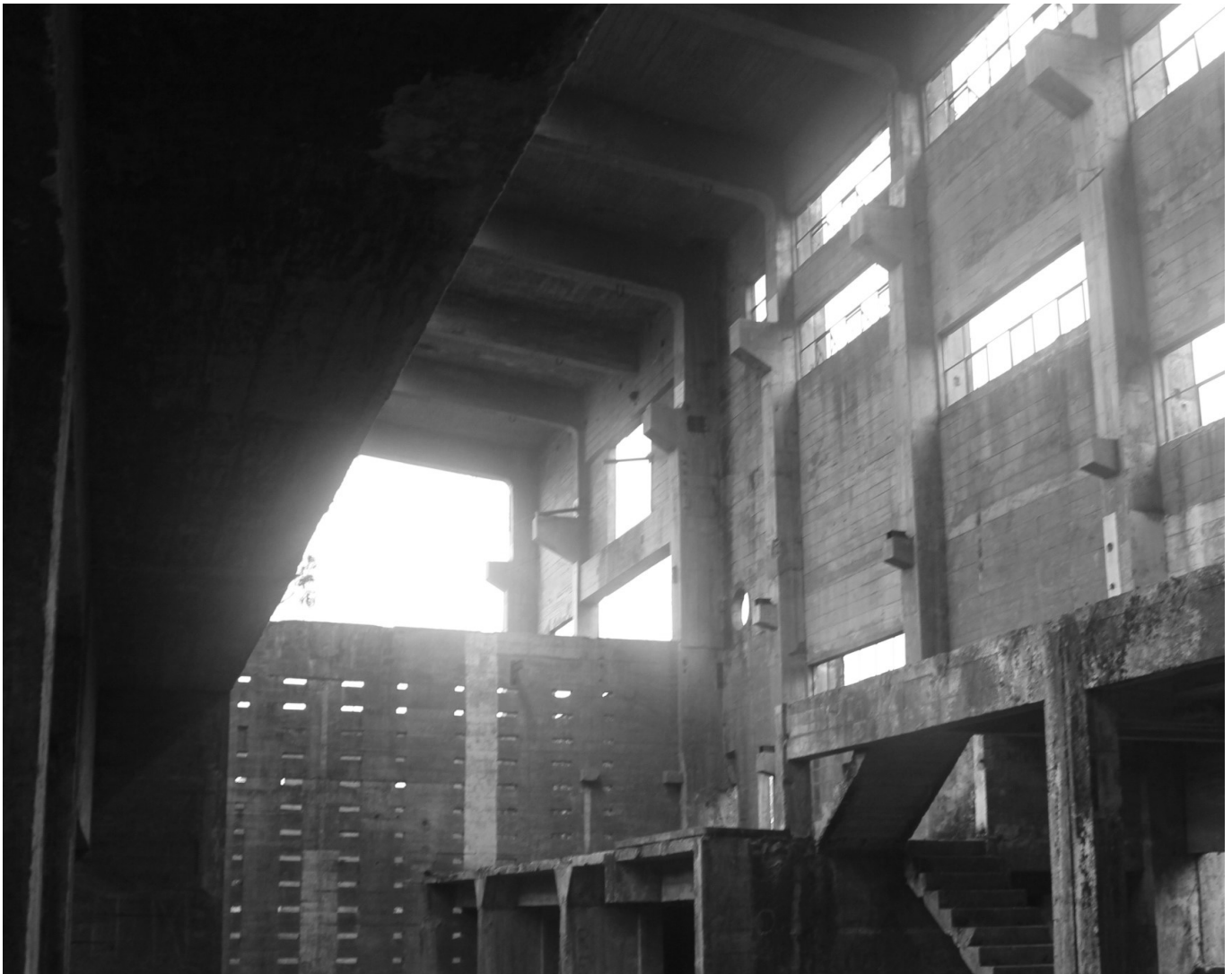
IMG.17_ Vista Interior del Edificio Principal, desde el Acceso Principal. 47 Fuente: Archivo de Expedientes, CMN Los Ríos.
