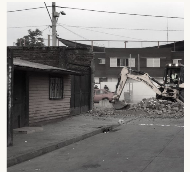
Imagen N°27: Derrumbe de muros en La Legua | Fuente: Ministerio del Interior
