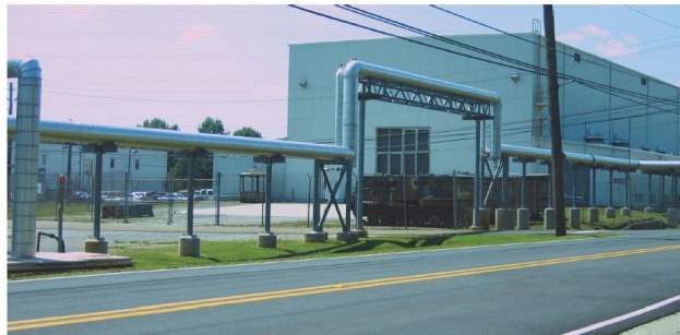
Figura 3.12: Tuberías superficiales de la red de distribución [41]
