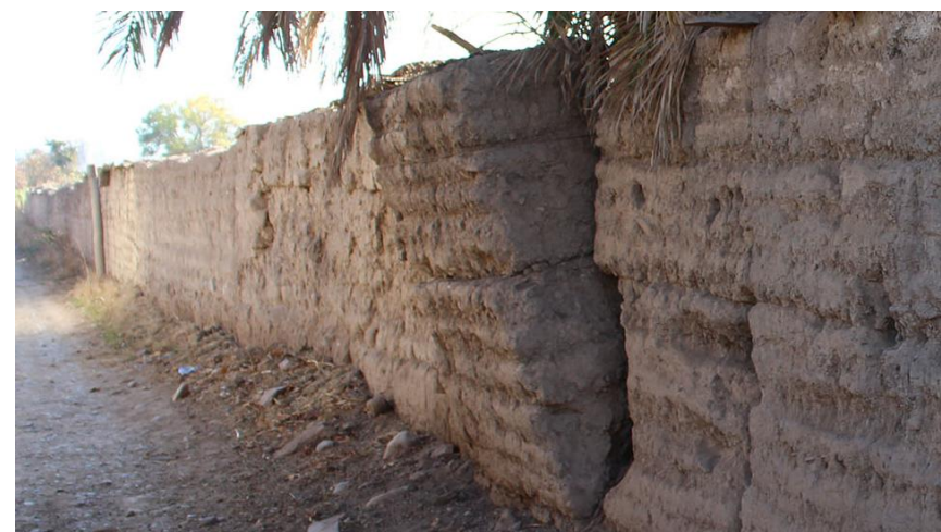
Figura 118. Desaplome. Fuente: Elaboración propia.
