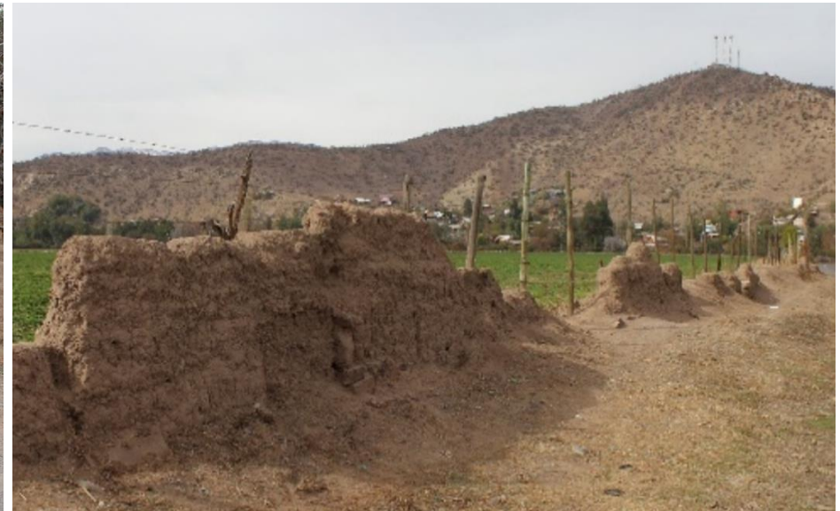
Figura 220. Tapia en estado de destrucción total. Fuente: Elaboración propia
