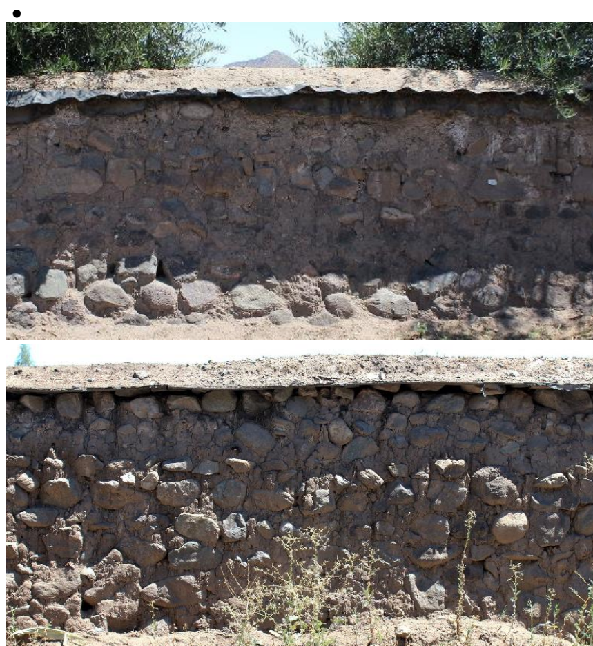
Figura 53. Dos casos de muros híbrido entre pirca y tapial. Fuente: Elaboración propia.
