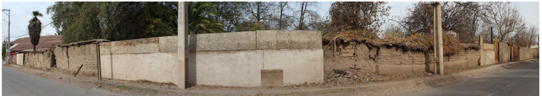
Figura 210. Mal estado de conservación de las tapias y cerramientos discordantes. Fuente: Elaboración propia.
