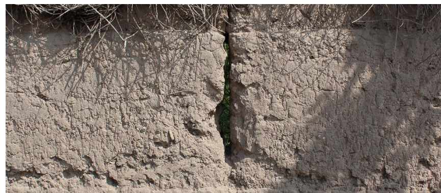
Figura 116. Desvinculación de juntas. Fuente: Elaboración propia.
