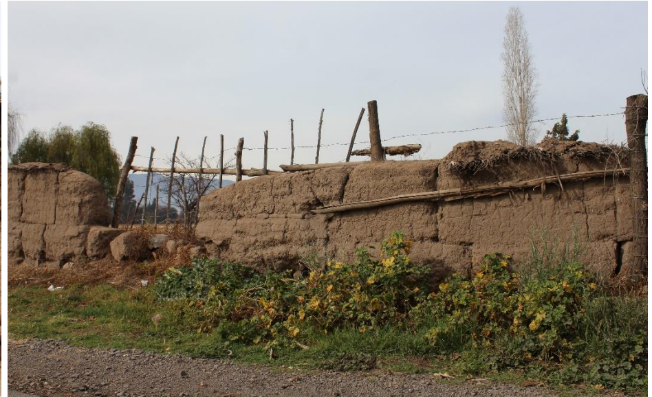
Figura 219. Tapia en mal estado de conservación. Fuente: Elaboración propia
