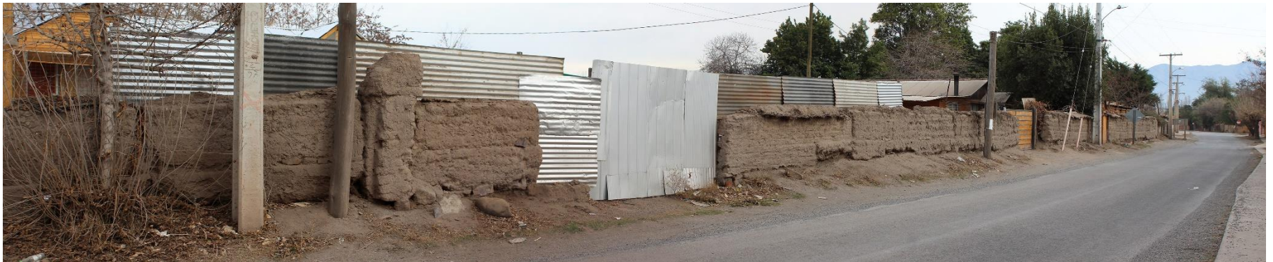
Figura 209. Mal estado de conservación de las tapias y cerramientos discordantes. Fuente: Elaboración propia.
