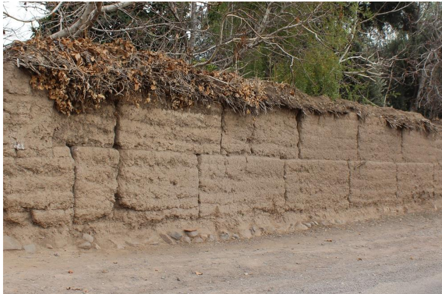
Figura 218. Tapia en regular estado de conservación. Fuente: Elaboración propia
