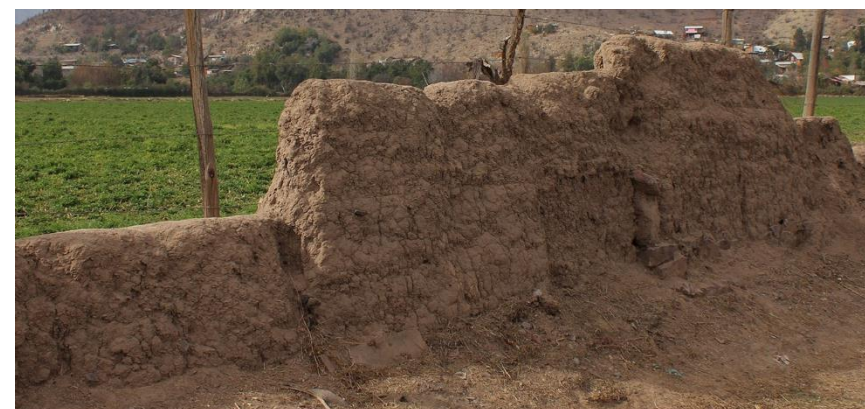
Figura 117. Ausencia de partes y erosión. Fuente: Elaboración propia.
