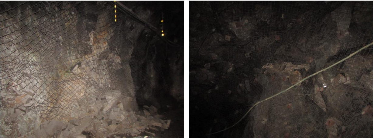
Figura 62 Condición de labores en CAL techo, con lajamiento menor en techo y pilares de las galerías. (Zarate A, Lagos C, 2018)
