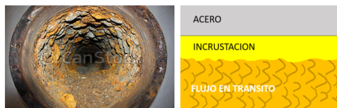
Figura 3.2: Sedimentación en cañerías.
