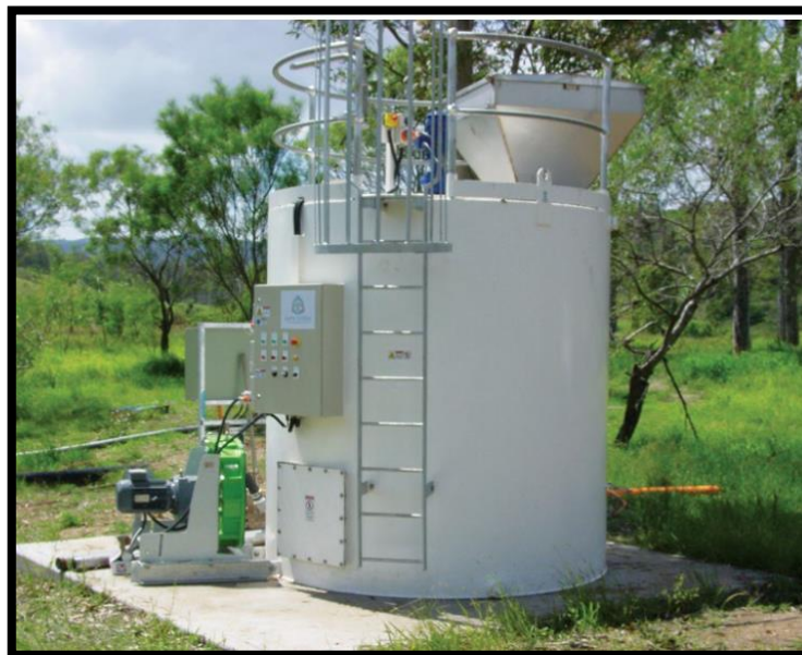
Figura 5.24 Tanque de mezcla vertical.
