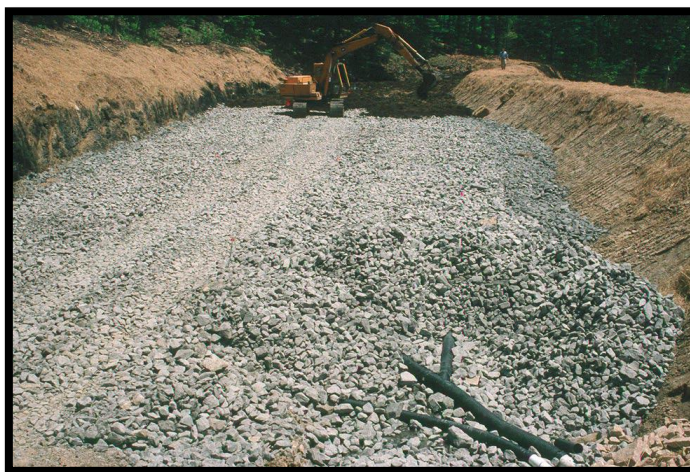
Figura 5.35 Tuberías en el fondo del SAPS.
