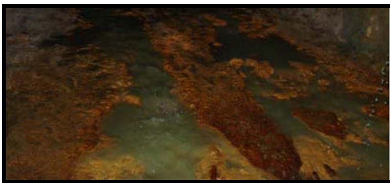
Figura 2.30 Precipitados de hidróxido férrico en el drenaje de El Teniente.
