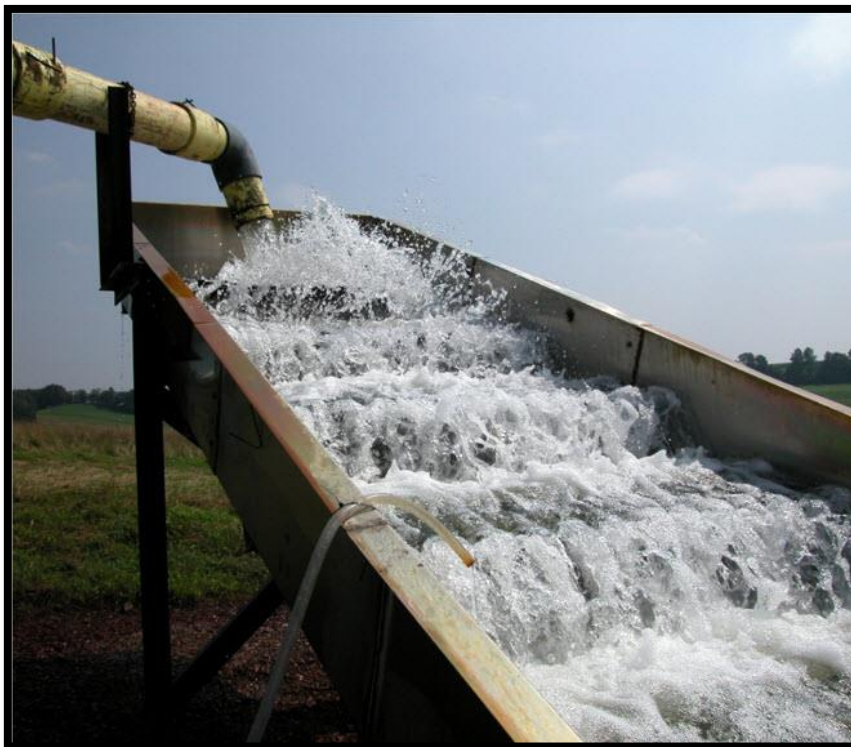
Figura 5.32 Canal de aireación en cascada basado en la gravedad.
