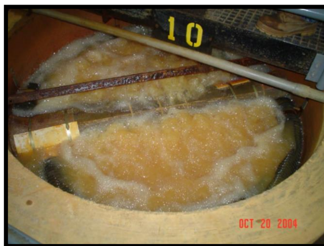
Figura 5.30 Pozos de desviación para tratamiento de aguas ácidas.
