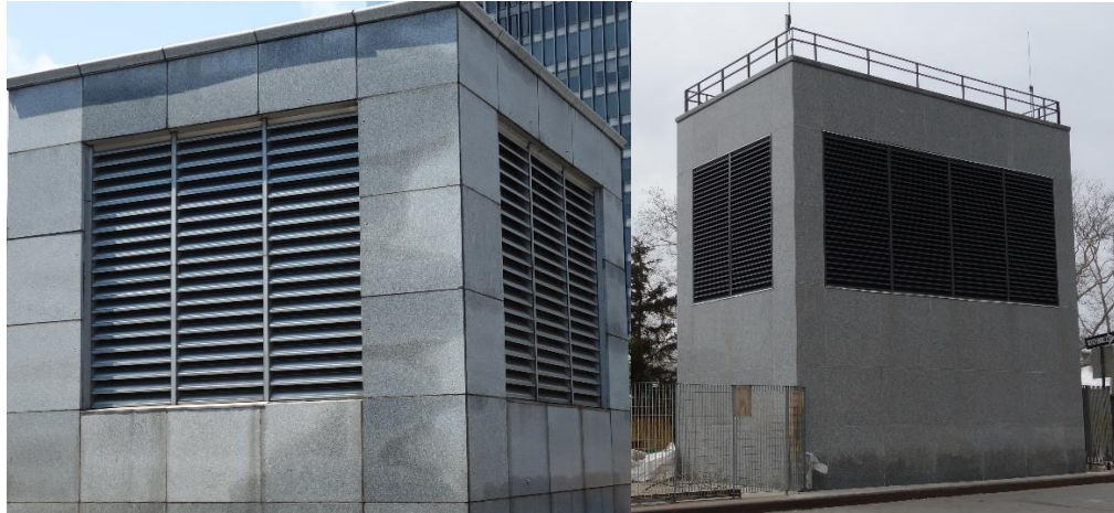
Figura 4: Celosías de ventilación instaladas en muros de edificios urbanos. [9]
