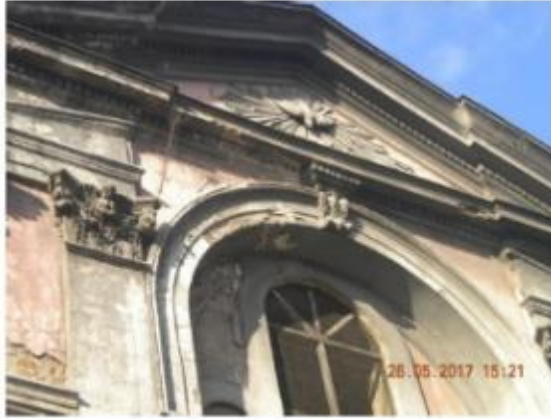
Fisuras en torno a vanos en fachadas – Falla en arco sur.
