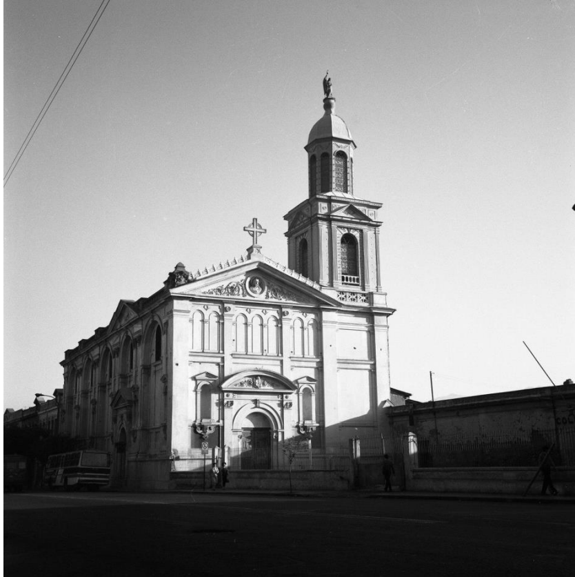
Imagen 49. Iglesia del Carmen Bajo en restauración (Desconocido, 1980) Fuente: Archivo Fotográfico Dirección de Arquitectura. URL: www.afda.cl
