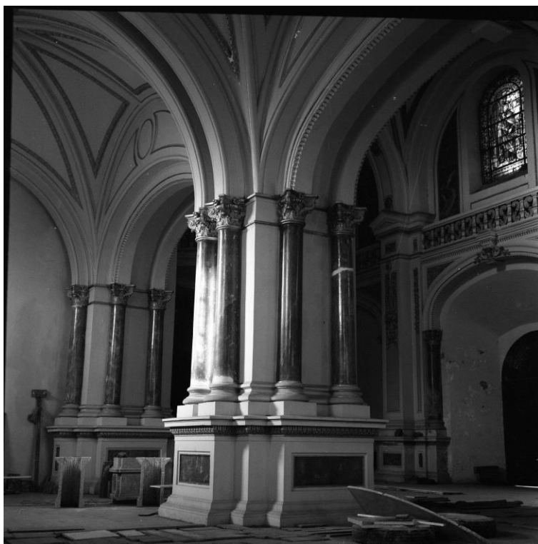
Imagen 45. Restauración iglesia del Carmen Bajo donde se muestra la instalación del nuevo pavimento (Desconocido, 1980) Fuente: Archivo Fotográfico Dirección de Arquitectura. URL: www.afda.cl
