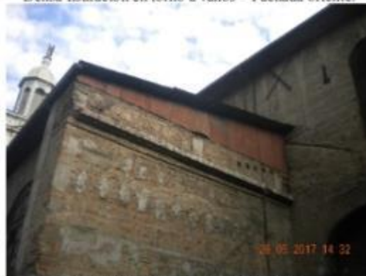
Nave lateral oriente con fisuras leves.
