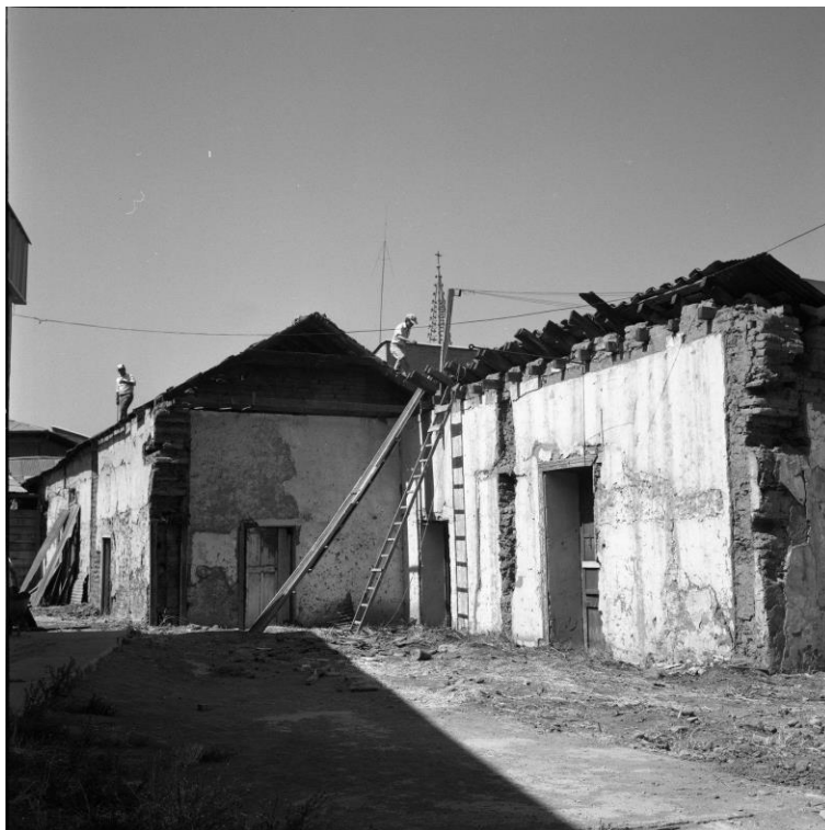
Imagen 44. Vista desde el oriente hacia la iglesia (Desconocido, 1980) Fuente: Archivo Fotográfico Dirección de Arquitectura. URL: www.afda.cl
