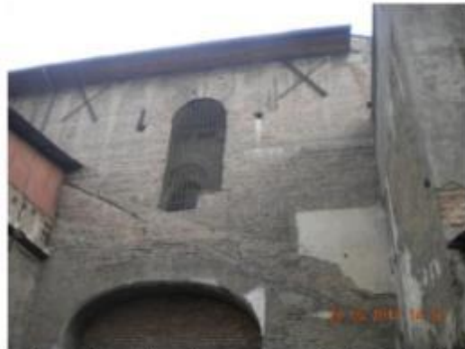
Densa fisuración en torno a vanos – Fachada oriente.
