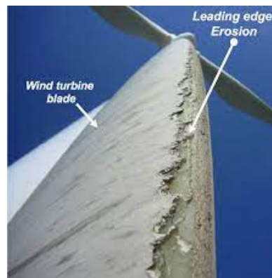
Figura 4.6: Alabe de una turbina Eólica que presenta problemas de delaminación, una de las razones tras la reducción de la energía producida con el tiempo, autor desconocido.
