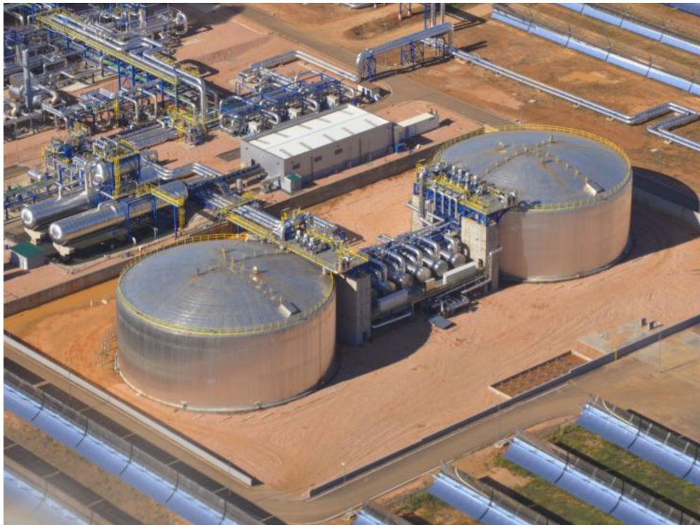
Figura 3.27: Estanques dobles de sales fundidas utilizados en la planta CSP Extresol 1 de España, con 14[m] de altura, y 36[m] de diámetro, Imagen obtenida desde el fabricante Nervión industries [40].
