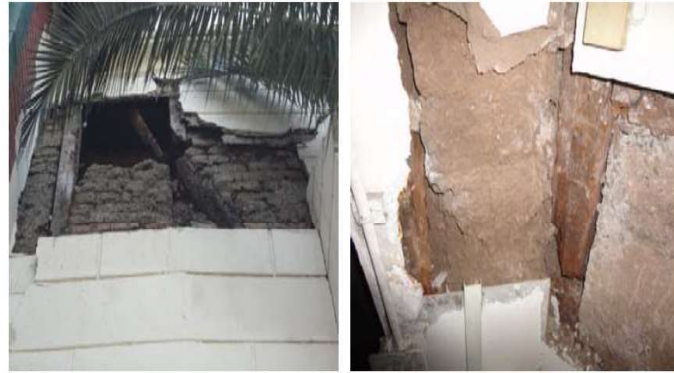
Figura 4.24: Daños en muros de maderas y adobes. [21]
