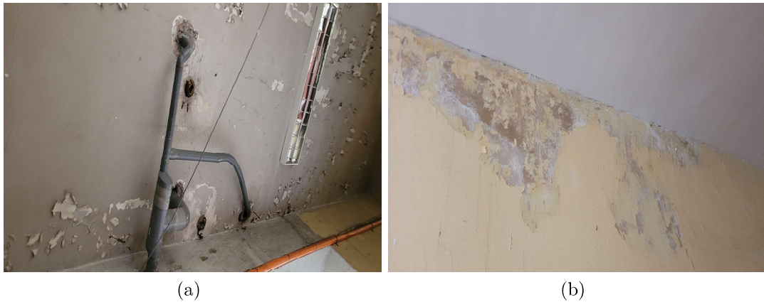
Figura 4.11: (a) Cubierta segundo nivel bajo zona de comedor y (b) Muros con daños por humedad. Fuente: Elaboración propia.
