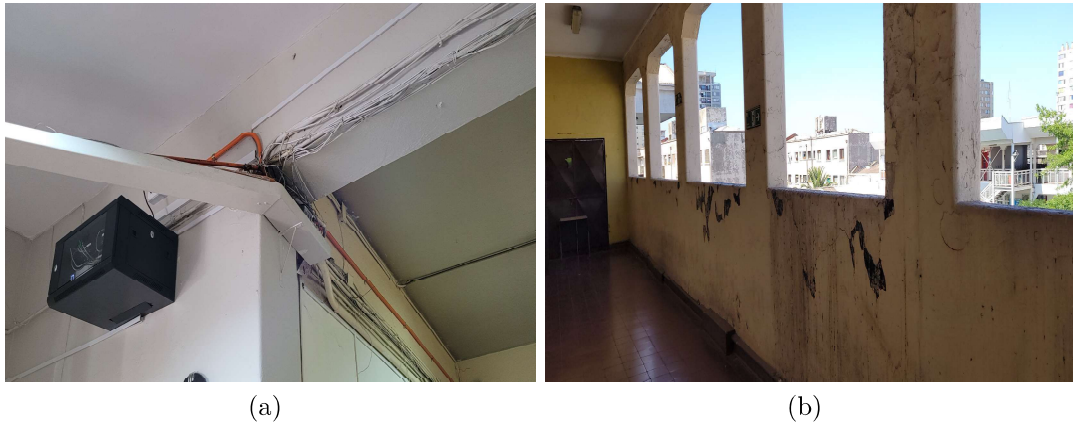
Figura 4.10: (a) Sistema eléctrico expuesto y (b) Muros con daños por humedad. Fuente: Elaboración propia.
