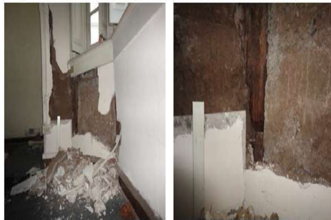
Figura 4.27: Parches antiguos de cemento.[21]
