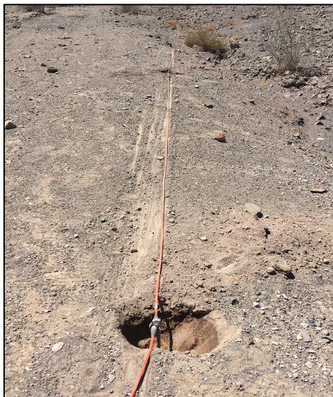
Figura 4.14: Electrodo en un agujero humedecido con abundante agua para bajar la resistencia de contacto.
