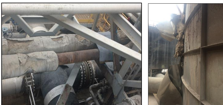
Figura 12 Líneas de electrolito con deficiente aislación térmica
