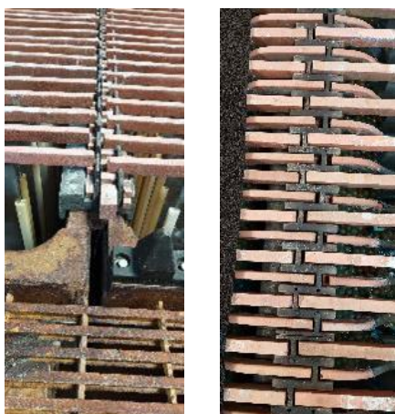
Figura 16 Celdas con desplazamiento y contacto deficiente en EO
