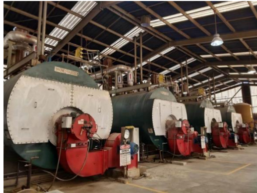
Figura 8 Sala de calentadores SX-EW
