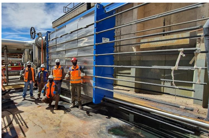
Figura 14 Nuevo intercambiador de calor E-E
