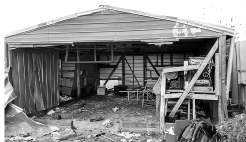
Imagen capturada tras la destrucción de la bodega/ refugio en 2018. Fuente: Gentileza de Diego Perez de la Guafo Island Science..
