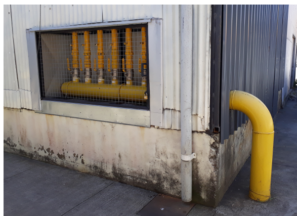
(b) Manifold de distribución de las tuberías de gas natural hacia las calderas con válvulas de corte.
