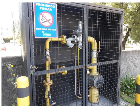
(a) Punto de inyección del gas natural con regulador de flujo, medidor de gas y válvulas de corte.
