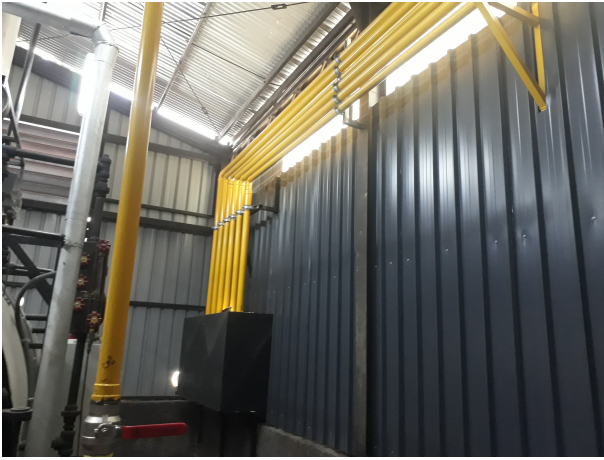
(a) Seis tuberías de distribución del gas natural a las calderas.
