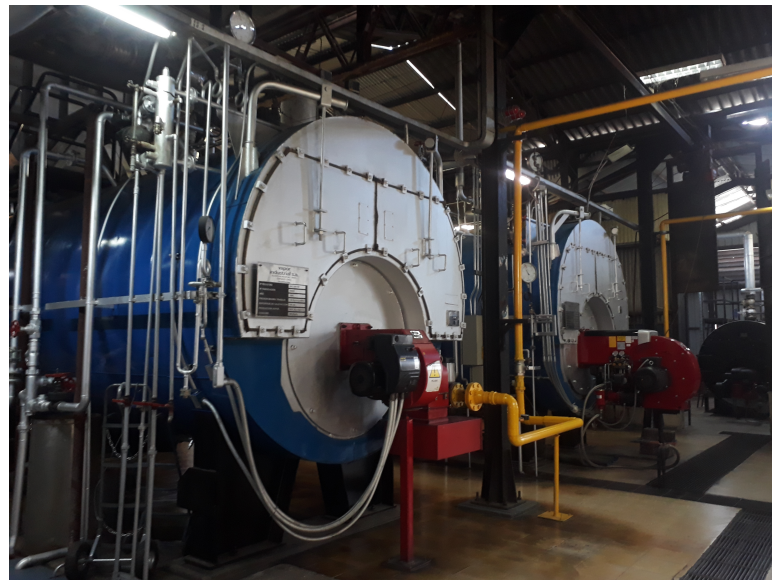
Figura 4.12: Vista frontal calderas a gas natural fabricante Vapor Industrial N° serie 95033 (izquierda) y N° serie 86021 (derecha).
