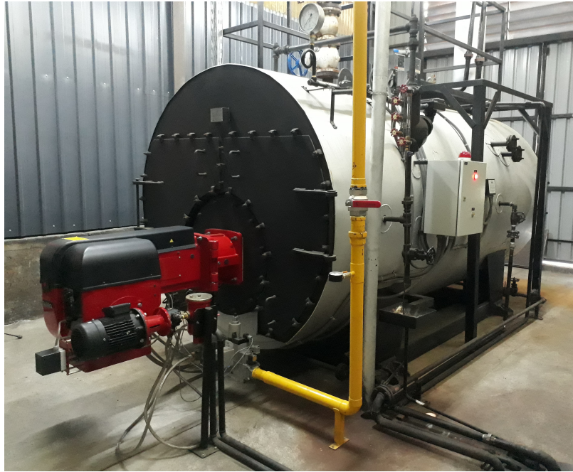
Figura 4.11: Vista frontal de la caldera de generación de vapor a gas natural fabricante Dueik modelo DSS-150-100-GOH.
