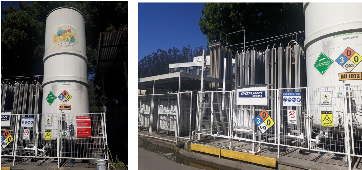
(a) Estanque de oxígeno criogénico. (b) Vaporizadores para la conversión de oxígeno líquido en gaseoso.
