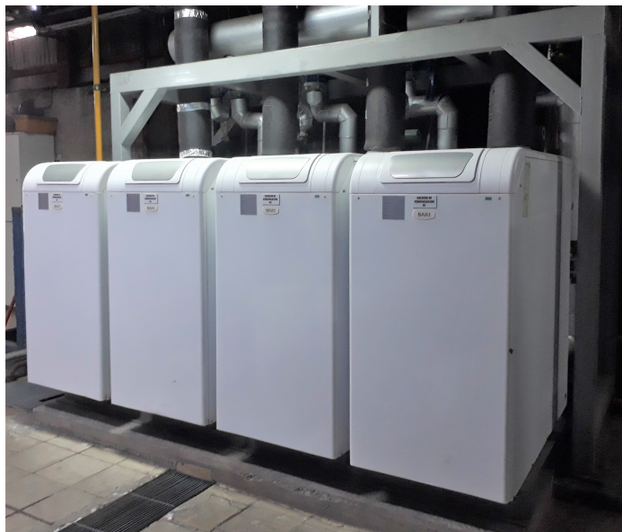
Figura 4.8: Vista frontal de las calderas de condensación a gas natural fabricante Baxi SPA modelo Power HT 1.320.
