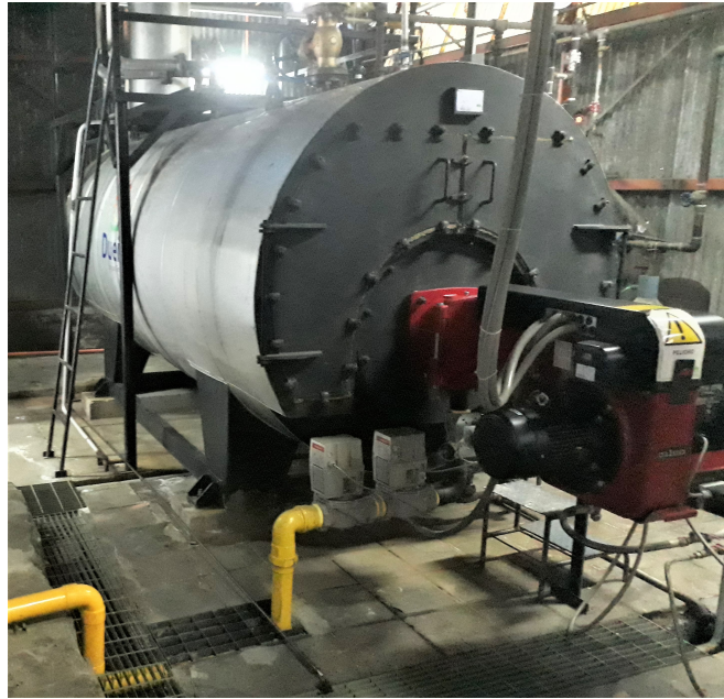
Figura 4.10: Vista frontal de la caldera de generación de vapor a gas natural fabricante Dueik modelo DSS-175-100-GOH.
