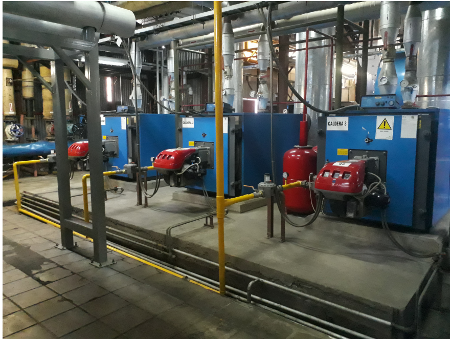
Figura 4.9: Vista frontal de las calderas calentadores de agua a gas natural fabricante IVAR.
