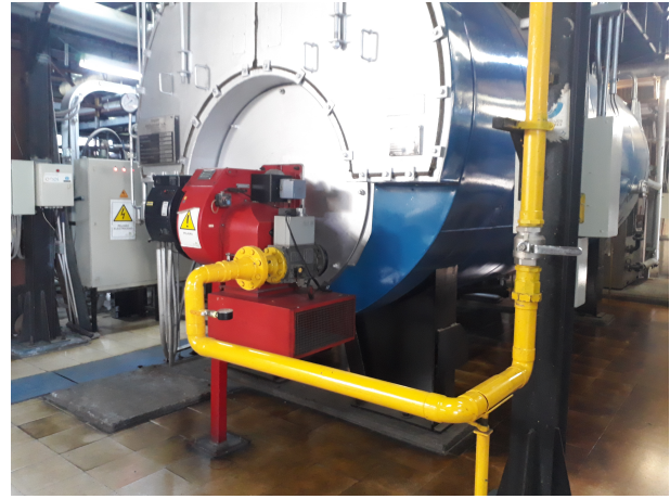
(b) Inyección del gas natural al quemador con válvula de corte, manómetro y rampa de gas.
