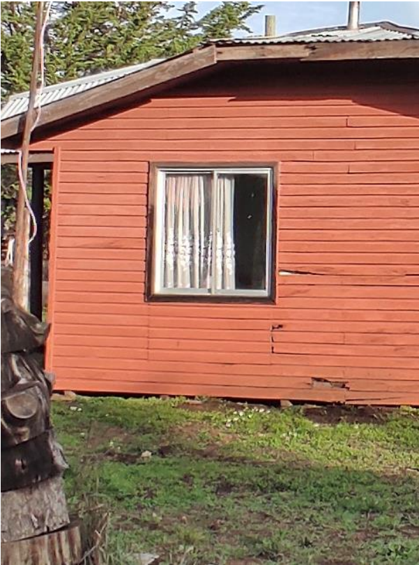
Fotografía 30: María. Segunda vivienda fachada norte. Se observa deterioro. Registro propio.
