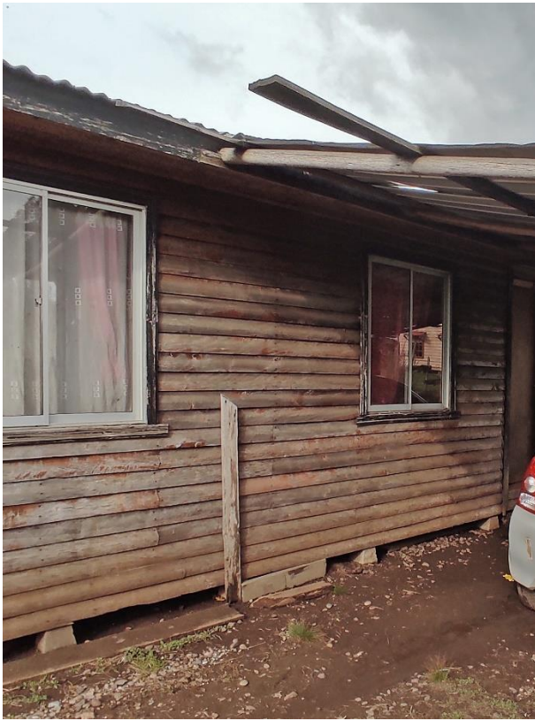
Fotografía 43: Rosa. Fachada norponiente con evidencia de deterioro. Registro propio.
