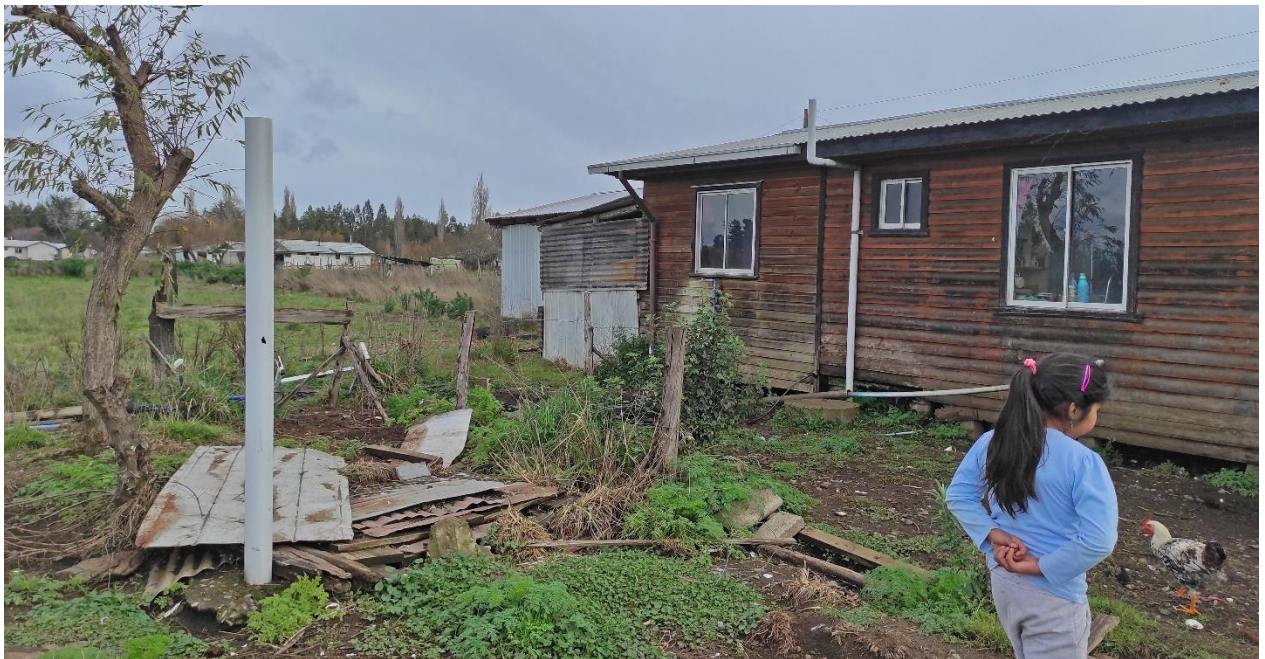
Fotografía 45: Rosa. Fachada oriente. Se observa pozo de drenaje y ventilación, además de ventilación de cámara sanitaria domiciliar. Apozamiento de aguas servidas y deterioro de revestimiento de la vivienda. Registro propio.
