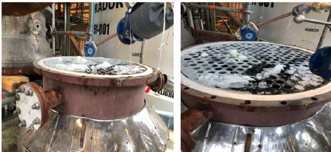
Figura 21: Incrustaciones de sulfato en el interior de los tubos del rehervidor
