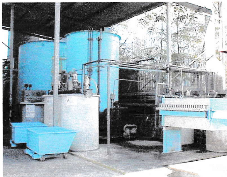
Figura N° 25. Foto del área de tratamiento de Riles.
