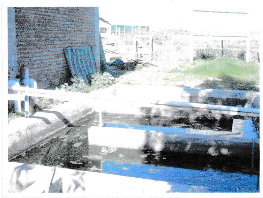
Figura 18. Sistema de bombeo hacia sector de viñas
