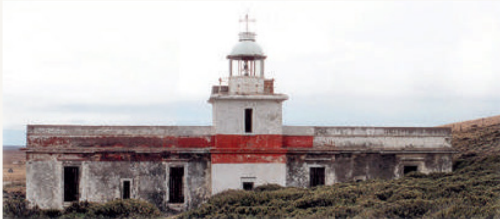
Figura 25. Faro Posesión y actual condición de deterioro y abandono Fuente: Libro "Faros del Estrecho de Magallanes" de Martinic y Fernández (2019)
