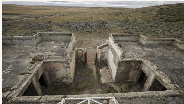
Figura 23. Patio central del Faro Posesión y actual condición de deterioro y abandono. Fuente: Cecilia Agüero vía flickr
