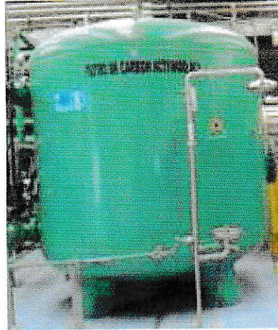
Figura 4. Estanques de Filtros de Carbón Activado.
