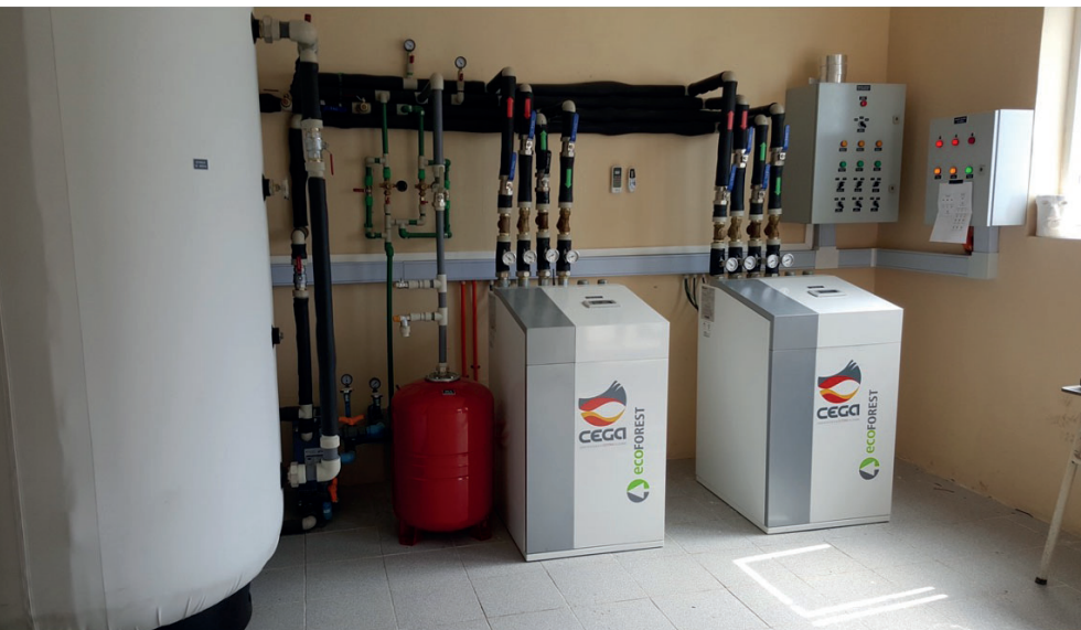
Figura 6. Bombas de calor geotérmico en Liceo Altos del Mackay. Fuente: Archivo CEGA.
