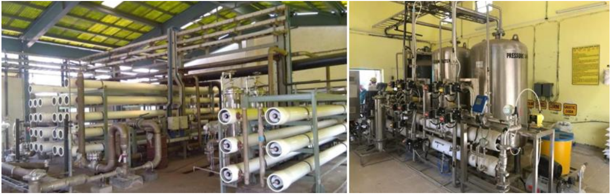
Figura 116: Planta desaladora RO Vodik. Fuente: Indiamart.
